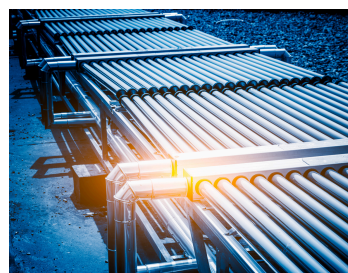
IMPIANTI SOLARI TERMICI
